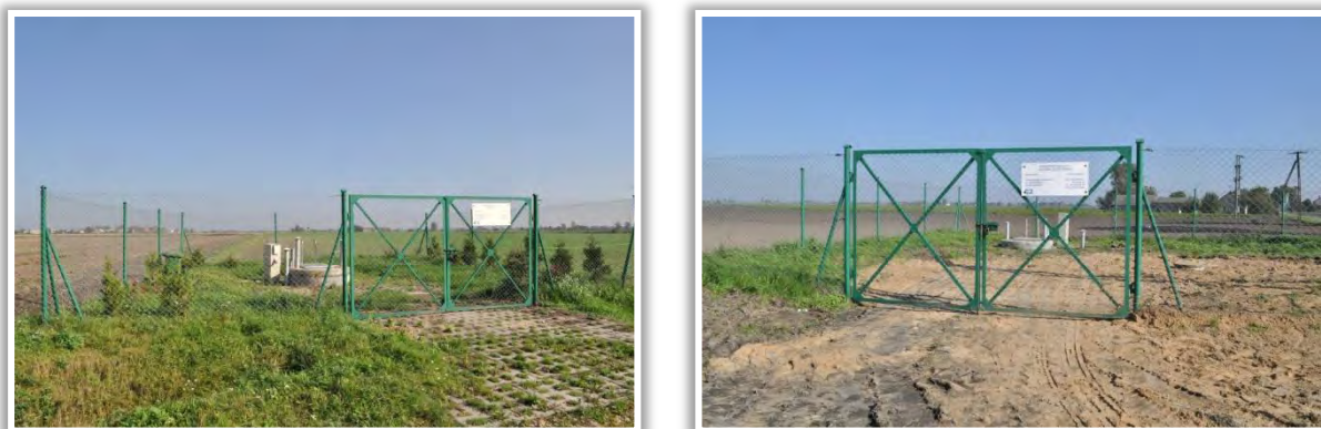
Ryc. 21. Przepompownie P-2 w Obórcie i P-1 w Kolonii Zdziechowa
