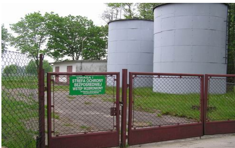
fot.2. Ujęcie wód podziemnych w Rozdrażewie.
