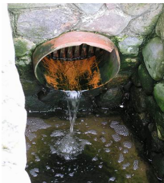
fot.7. Wylot ścieków oczyszczonych z terenu oczyszczalni w Rozdrażewie
