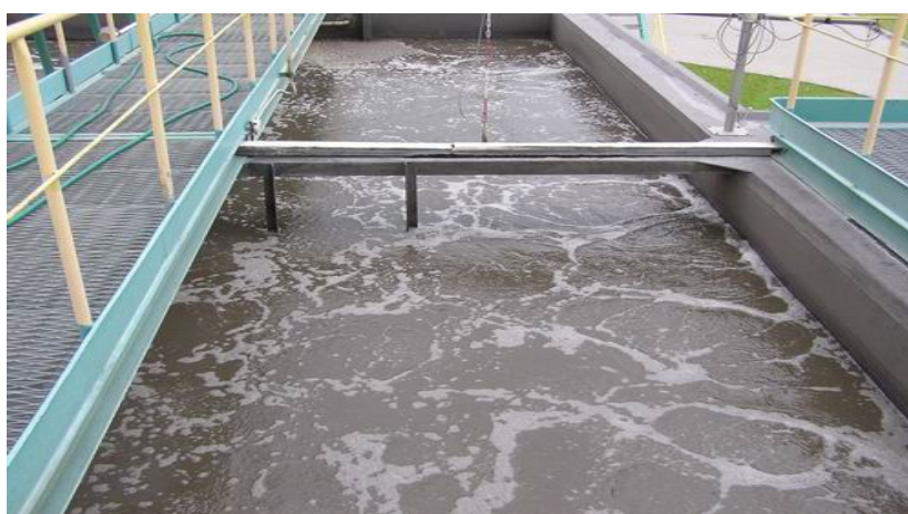
fot.6. Gminna oczyszczalnia ścieków w Rozdrażewie.
